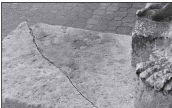
Obr. 3 Detail narušeného podstavce
